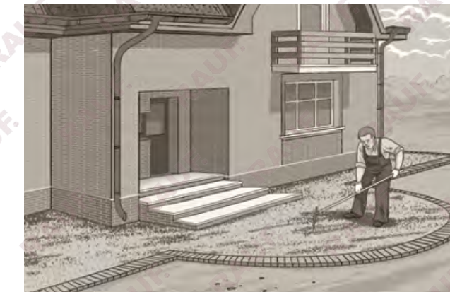
Подсыпка равномерно распределяется по поверхности несущего слоя и предварительно выравнивается с помощью подручного инструмента (например, граблей). Монтажный слой трамбуется (уплотняется) специальным электро- или бензоинструментом (виброплитой).
